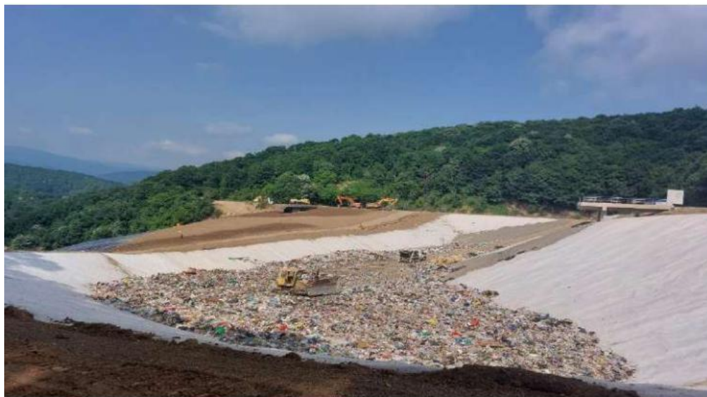
Слика 4.4.1. Санитарна касета на општинској депонији
