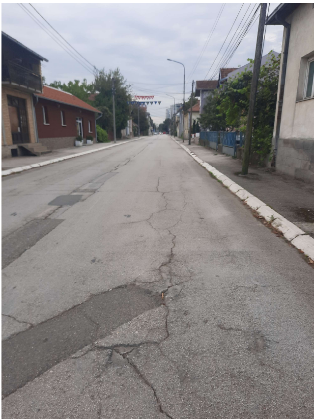
-оштећења на коловозу Улице Радоја Крстића
